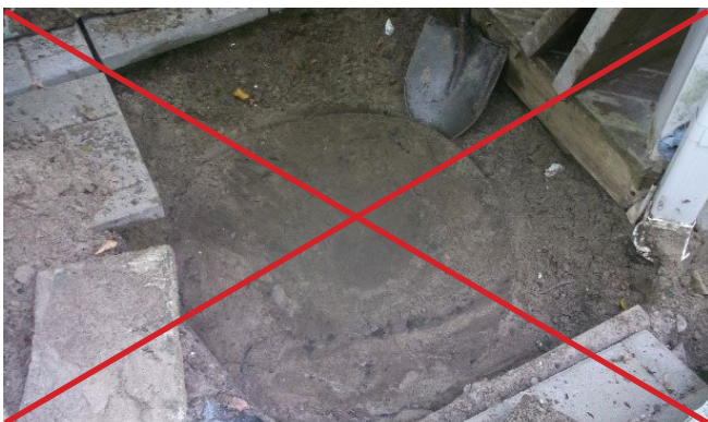
Figure 3 : Fosse sans cheminées d'accès et couvercles non accessibles (non conforme)
