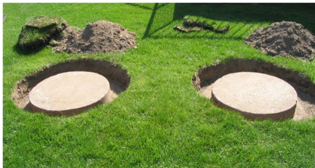
Figure 2 : Couvercles de fosses adéquatement dégagés
