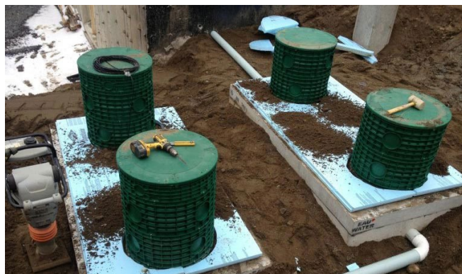
Figure 4 : Fosse munie de cheminées d'accès
